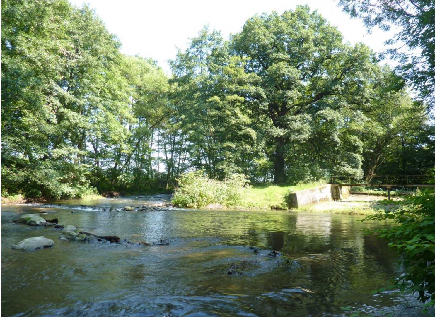
Abb. 31: Der Hochwasserumgehungsgraben (links) des Freudenthaler Wehres wurde naturnah umgestaltet und führt nun das Dhünnwasser ab. Über das Freudenthaler Wehr fließt nur noch Hochwasser ab. 31.07.2014
