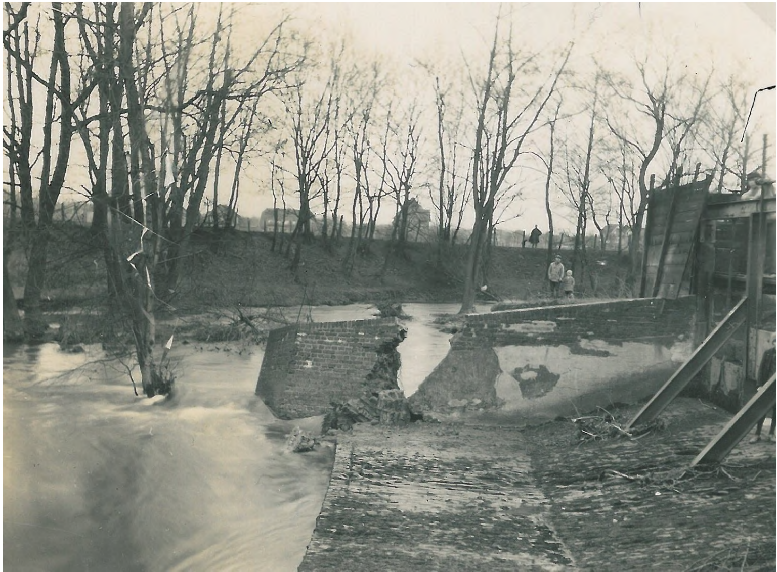
Abb. 38 Das Hochwasser vom 03. auf den 04.01.1932 hatte nicht nur die Feldbahnbrücke unterhalb des Freudenthaler Wehres zerstört (siehe Abb. 11 und 12). Auch die rechte Flügelmauer des Auermühlenwehres wurde beschädigt. 11.01.1932
